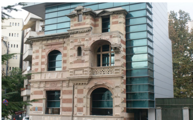
Na zachowanej fasadzie widoczne są ślady po kulach z okresu rewolucji
